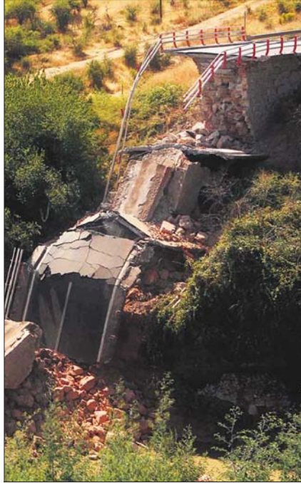
El puente sobre el río Claro, en Talca, que comunica con la zona de viñedos, resultó totalmente destruido.
