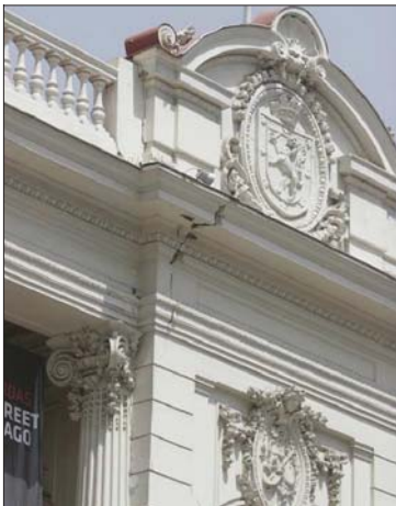
Una grieta se aprecia en el frontis del Teatro Municipal. En 1906 un terremoto destruyó el foyer de este coliseo.
