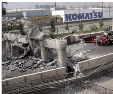
FUTUROS ARREGLOS.— Entre seis y doce meses podrían demorarse los trabajos de arreglo de los dos cortes que tiene la autopista Vespucio Norte.
