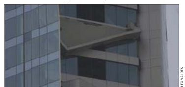
El primer rascacielos de Chile, Titanium La Portada, soportó muy bien el terremoto de 8 grados Richter en Santiago. Aun así, una estructura de vidrio de los pisos superiores se inclinó.
